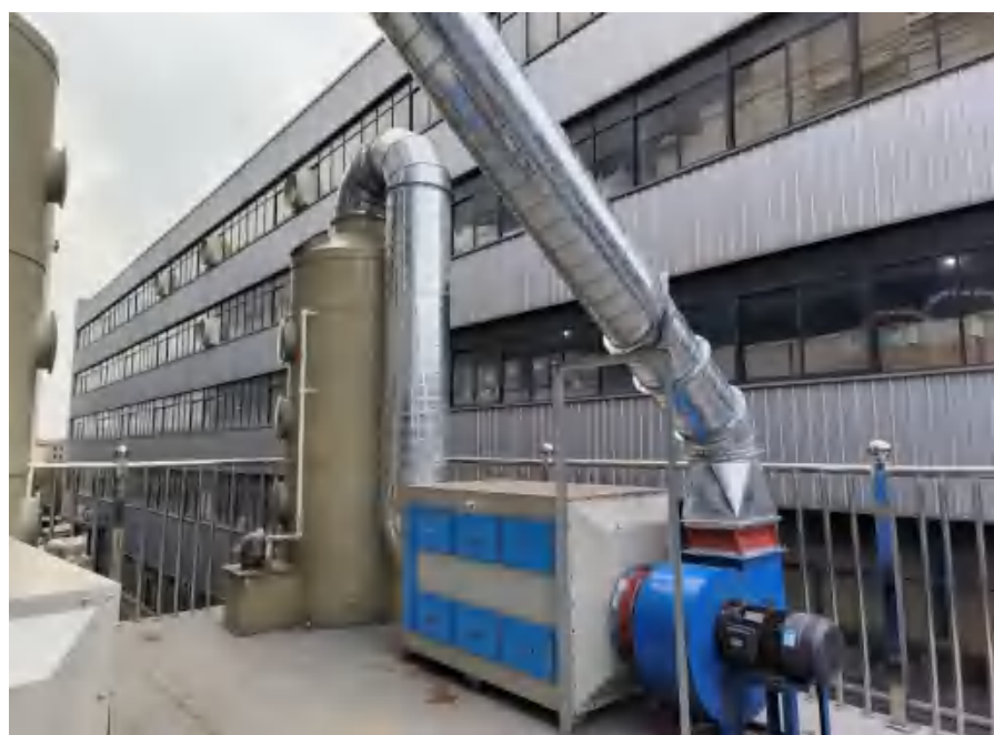
图 4-2.2 熔化烟尘处理设施照片
